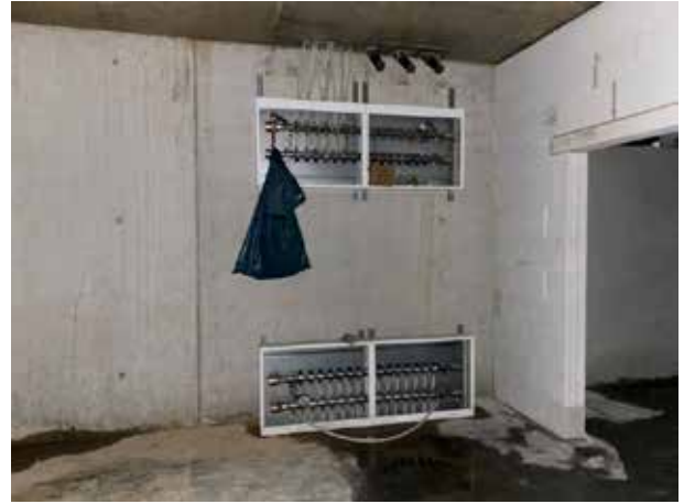
Premiers signes de l'installation du chauffage dans cette pièce du sous-sol. Nous travaillons de manière écologique avec une pompe à chaleur.
