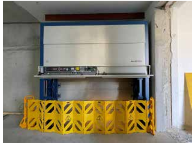
L'automate de stockage prend peu à peu forme.
