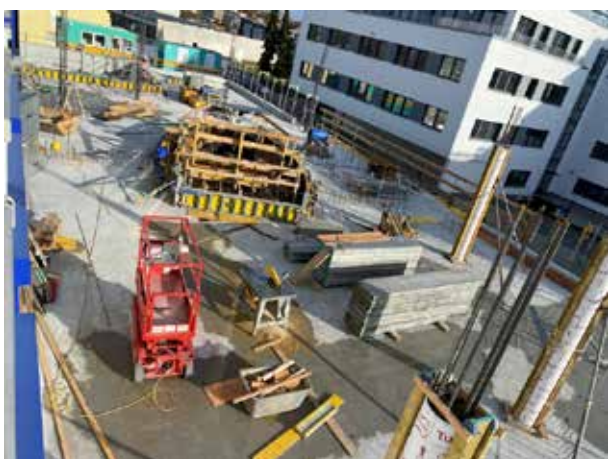
Dans la zone avant, les supports n'ont pas encore été maçonnés.
