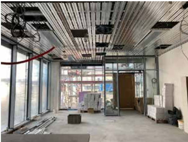
Dans l'entrée, le plafond chauffant/rafraîchissant est presque terminé, de sorte que les conduites peuvent y être posées.
