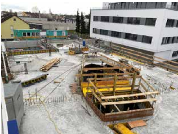
Ils travaillent déjà à nouveau sur le coffrage de l'ellipse de l'escalier. La première chose qu'ils font est le "pont".
