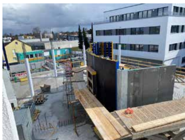
Les contours de l'ellipse de l'escalier du 1er étage sont déjà visibles à travers le coffrage. Entre-temps, les colonnes de la zone avant ont également été bétonnées.
