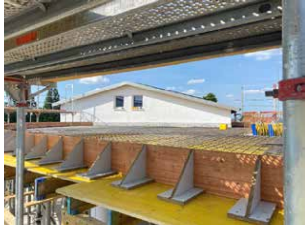
Encore un coup d'œil sur le bâtiment existant. Les rebords des fenêtres de toit servent de support aux tresseurs d'acier.
