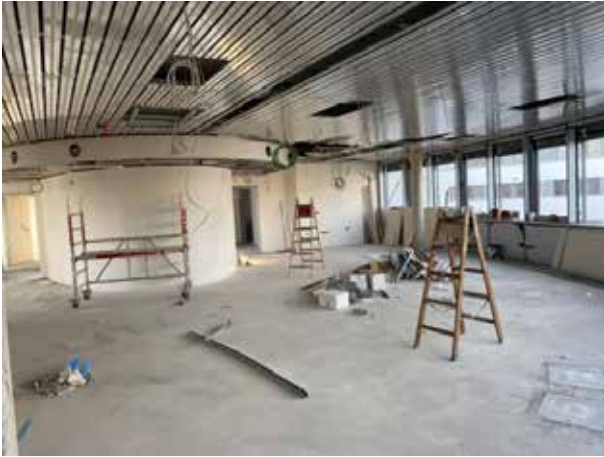
Le plafond climatisé est également en cours d'installation dans le bureau à aire ouverte du 2 e étage.
