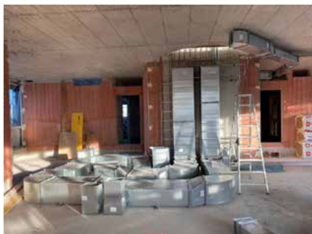
Une partie des gaines de ventilation passe ici sous le double plancher. Espérons que les monteurs connaissent bien cet enchevêtrement de gaines !
