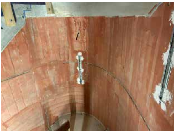
La cage d'escalier attend encore d'être enduite. Pour l'instant, elle n'est qu'appêtée.
