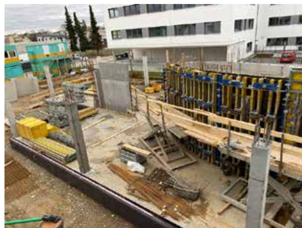
À la fin de la semaine, le revêtement de l'autre côté de l'escalier est presque terminé. À l'avant du bâtiment, le rez-de-chaussée et les étages supérieurs auront une façade en verre qui vous invite à entrer. Au début de la photo, vous pouvez voir la future zone d'entrée, où nos visiteurs trouveront une exposition de nos produits et de leurs domaines d'application.
