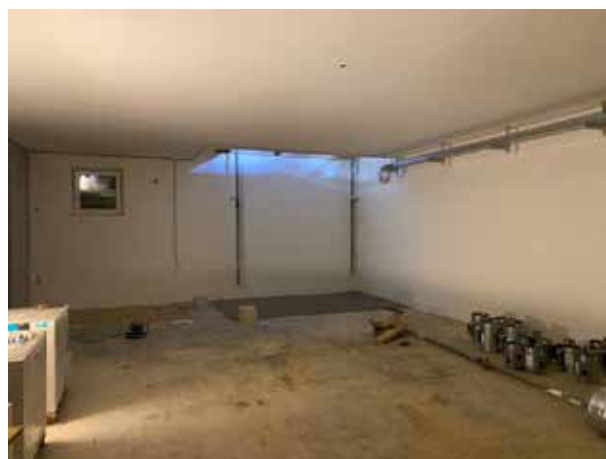
C'est ici que se trouvera l'automate de stockage - mais ici, seule la vue du rez-de-chaussée est visible. Il s'étendra sur deux étages : Sous-sol et rez-de-chaussée.
