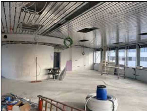
Une petite kitchenette sera située sur le mur au fond à droite.
