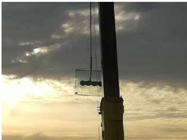
Les vitres de la verrière au-dessus de la cage d'escalier s'envolent. Elles ne tiennent pas à un fil, mais à des ventouses en verre - mais celles-ci tiennent.
