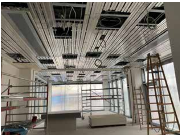
Le plafond chauffant et rafraîchissant et les unités de ventilation sont installés dans la salle multifonctionnelle.
