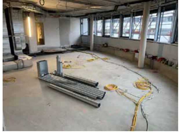
Au premier étage, il n'y a pas de chape, car un double plancher recouvrira plus tard toutes les conduites, canalisations et câbles au sol. Ici aussi, le chauffage/refroidissement est posé dans le plafond.
