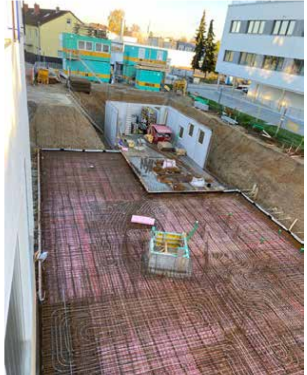
Tout est prêt pour le bétonnage de la partie arrière du sous-sol.
