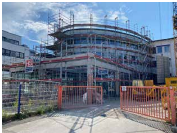
La plupart des éléments de la façade sont déjà en place - mais il manque encore les nombreux joints d'étanchéité.
