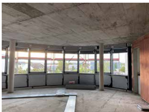
Grâce aux boîtes de sortie carrées, on peut déjà s'imaginer grossièrement où se trouveront plus tard les bureaux. Sur les fenêtres, on peut voir les stores montés à l'extérieur.
