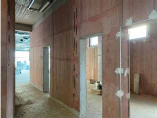
Au rez-de-chaussée aussi, tous les murs en béton ont déjà reçu une couche de fond.
