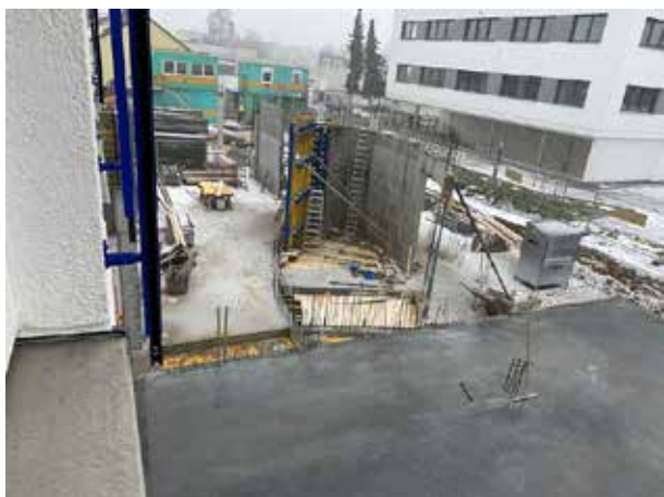
Le sol du futur entrepôt est déneigé, le bardage de l'ellipse de l'escalier a été enlevé et l'autre côté a commencé à être bardé.
