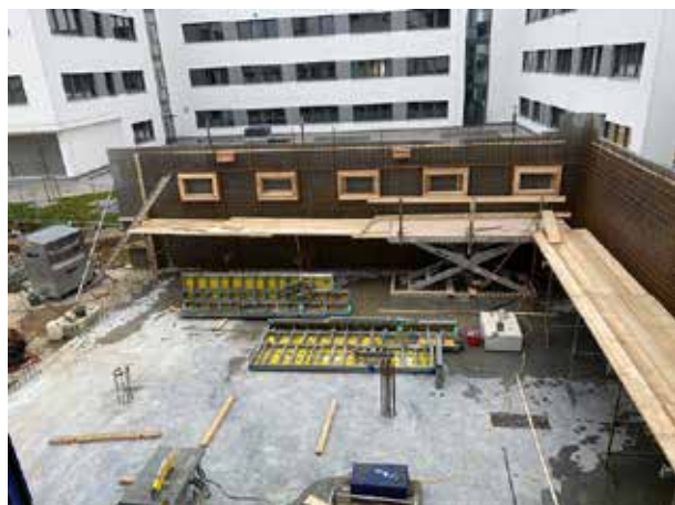
La zone arrière du rez-de-chaussée sera utilisée pour le stockage. Par conséquent, le coffrage pour le bétonnage des murs extérieurs est nécessaire à cet endroit. Le tressage de l'acier est presque terminé, de sorte que la face intérieure du coffrage pourra être fixée au cours de la semaine prochaine.
