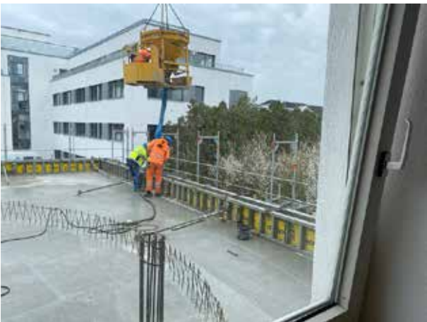
Le chantier se trouve juste devant la fenêtre du bureau : les bords de la toiture sont en train d'être bétonnés. Ici aussi, la charpente métallique laisse clairement apparaître les contours du premier étage.
