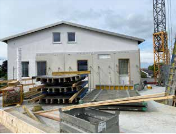
Vue sur l'ancien bâtiment depuis le deuxième étage du nouveau bâtiment. Ici aussi, deux fenêtres ont déjà été obturées par des éléments préfabriqués en béton.
