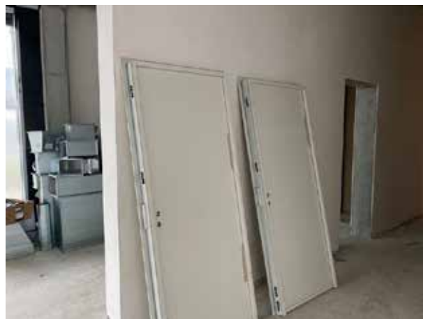
Les portes coupe-feu sont également montées. Au rez-de-chaussée, elles attendent encore d'être installées.
